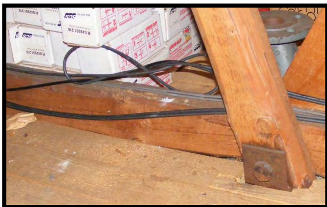
Billede 16 – Sådan skal kablerne ikke "smides" rundt (+)
