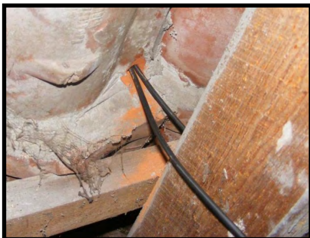
Billede 22 - Understrøget tag, hvor boring i teglsten har været nødvendig; udvendigt er tætnet med fugemasse
